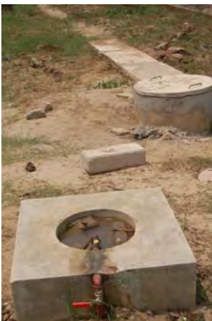
3 Sie liefert Energie ins Schulhaus
